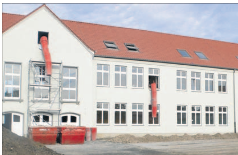
Noch haben die Bauarbeiter in der alten Realschule in Velgast das Sagen. Die Grundschüler sind nach den Ferien wieder Nutzer des Hauses, ziehen als erste Mieter ins Obergeschoss. Die Kita wird spätestens Anfang 2011 folgen.
