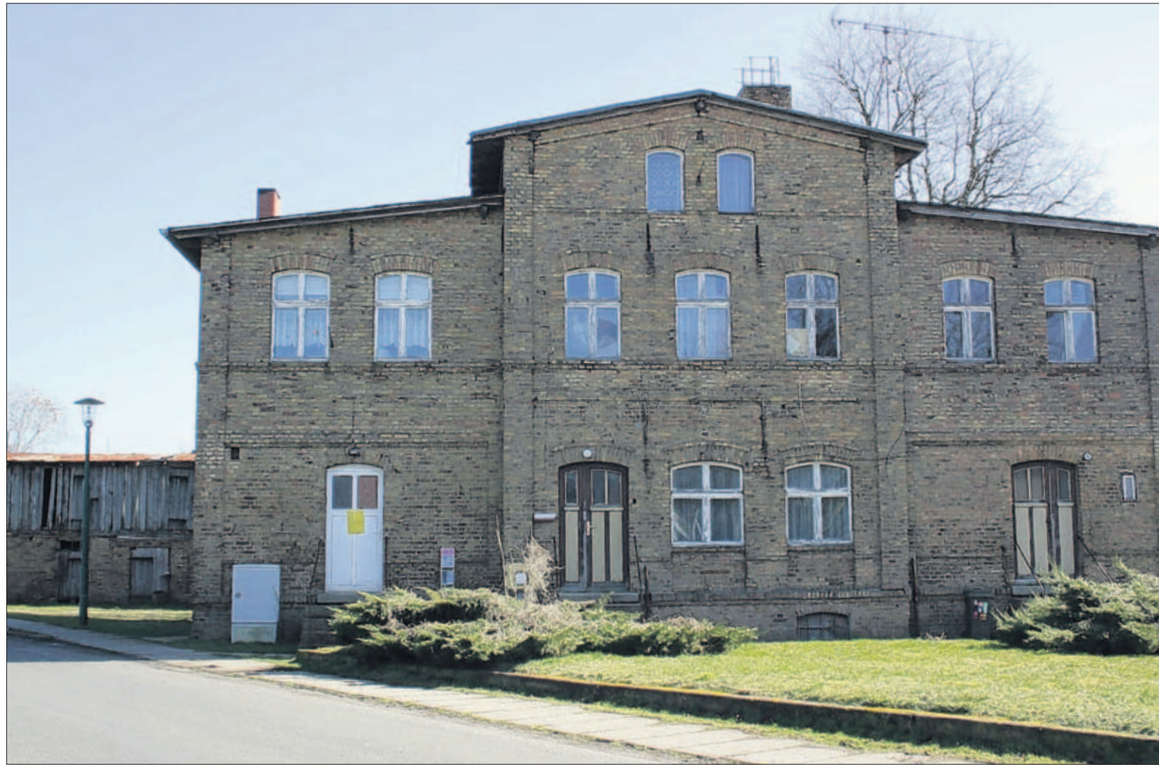
Völlig heruntergekommen ist das einstige Bäckereihaus in der Groß Mohrdorfer Lindenstraße. Nun kommt das Gebäude am 4. April bei den Norddeutschen Grundstücksauktionen in Rostock unter den Hammer. Foto: Ines Engelbrecht
